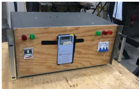
Figura 7 - Variador de frecuencias utilizado. Fuente: elaboración propia.
